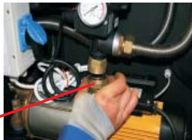
Druckstutzen der Pumpe
